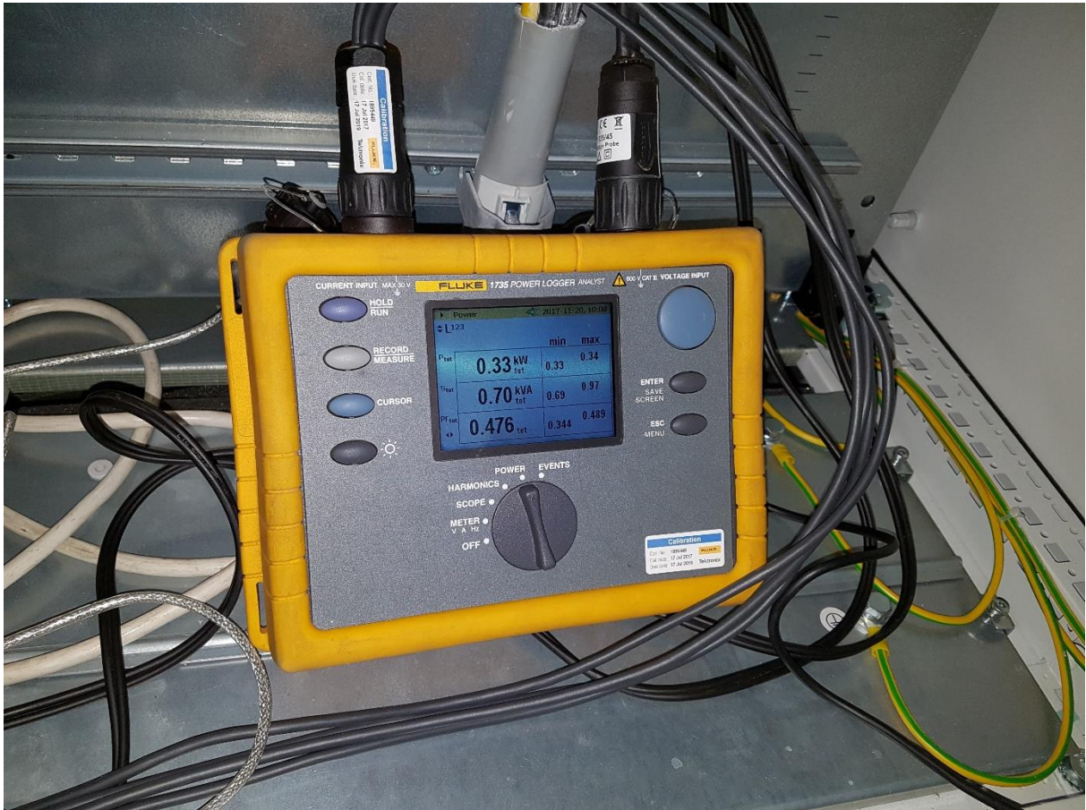
Abbildung 6-3: Fluke 1735 Messgerät im stationären Schaltschrank
